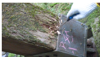
写真-1 アーチ端部の腐朽
