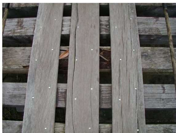
写真-2 著しく腐朽した床版材（12年目）
