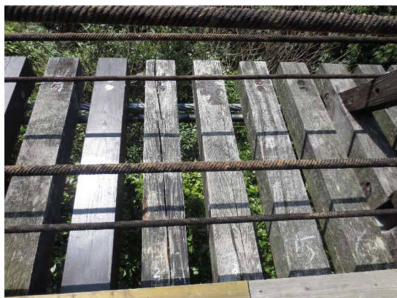
写真-4 25年目の床版材 (左から2番目は直前に交換されたもので 3番目はスギ材に交換されたものである)
