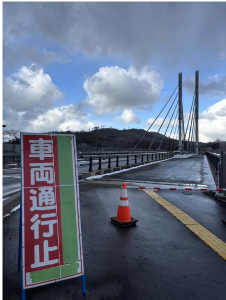
2025年2月5日17時～全面通行止め 原因：ボルト落下事故
